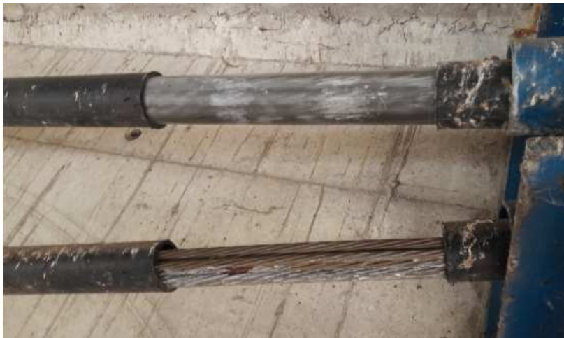
Défaut d'injection flagrant mais peu de corrosion
