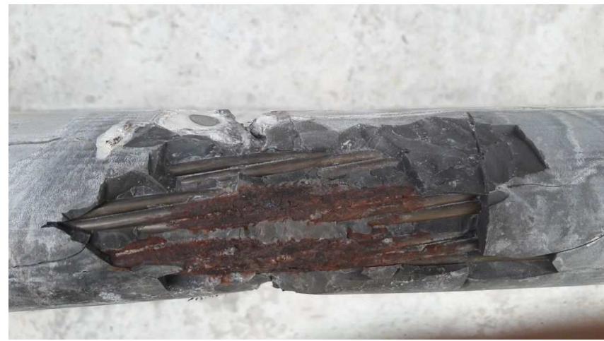
Défaut gaine minime (injection OK) mais corrosion flagrante
