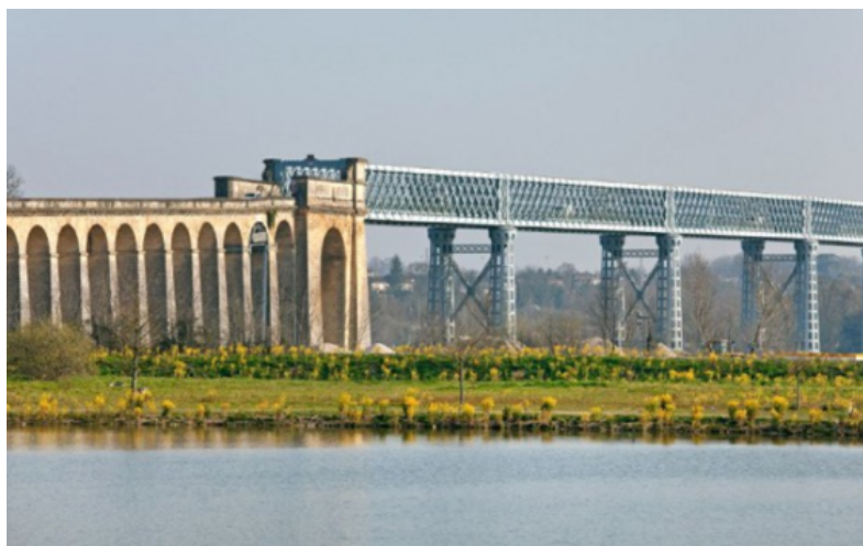
➤ Figure 8 : Tassement du viaduc d'accès en maçonnerie du pont de Cubzac
