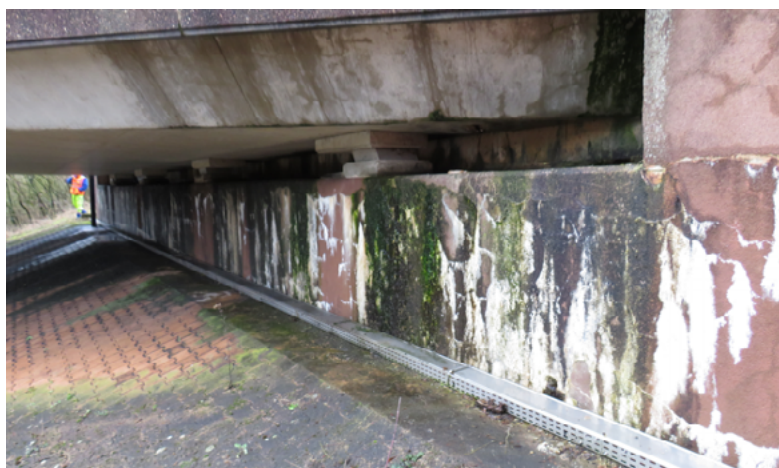
► Figure 5 : Chevêtre de culée atteint de RGI
