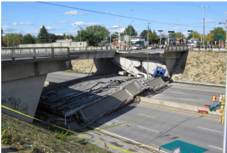
➤ Figure 4 : Vue générale de l'ouvrage après sa ruine
