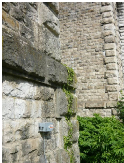
➤ Géophone installé sur le viaduc Epinay sous Sénart
